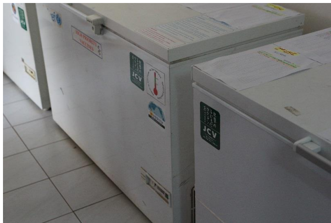
EPI に設置された JCV が支援した保冷库
