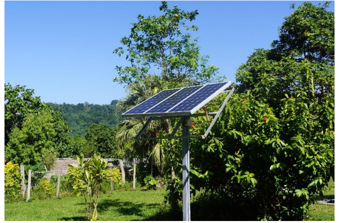
ソーラー発電機
