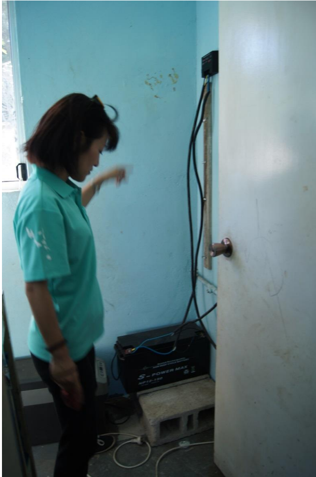
ソーラー発電機器を確認する JICA ボランティア
