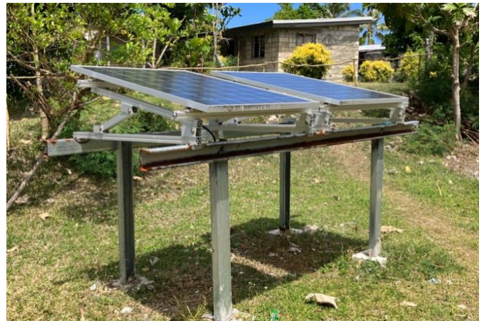
ソーラー発電機
