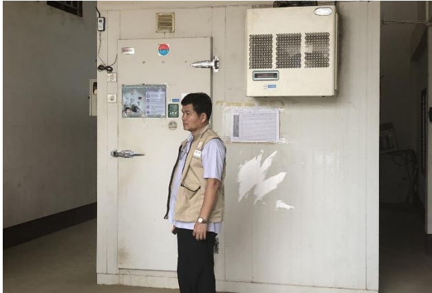
チャンパーサック県の施設に設置された JCV が支援した保冷库
