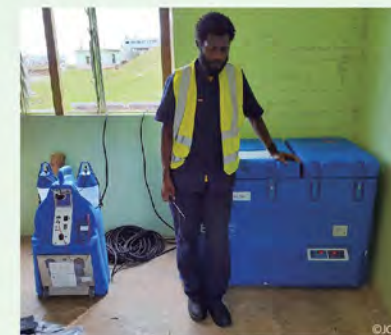
設置された簡易保冷庫と発電機
